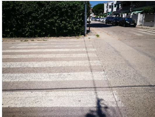
Imatge 23. Detall de l'estat del paviment i la pintura de la cruïlla
