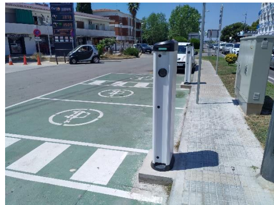
Imatge 51. Places de recàrrega elèctrica
