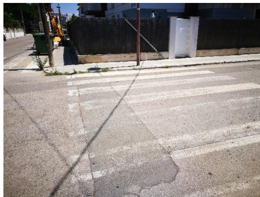
Imatge 25. Detall de l'estat del paviment i la pintura de la cruïlla
