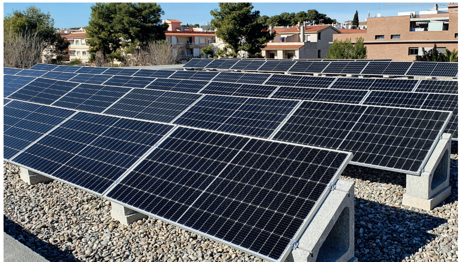
Imatge de plaques solars en edificis municipals.
