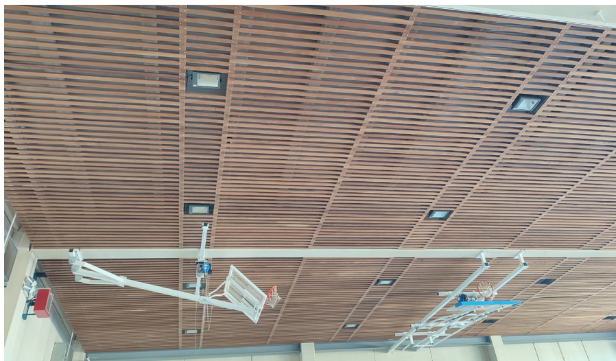
Nou sistema d'il·luminació al pavelló.
