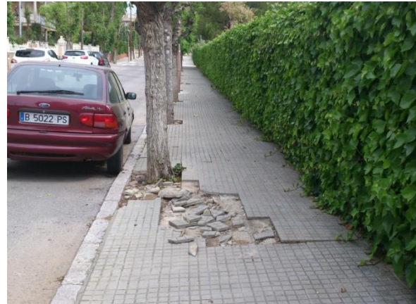
Imatge 14. Carrer de Frederic Travé. El mal estat de la vorera crea un risc de caigudes a la via, successos que també són accidents a la via pública.
