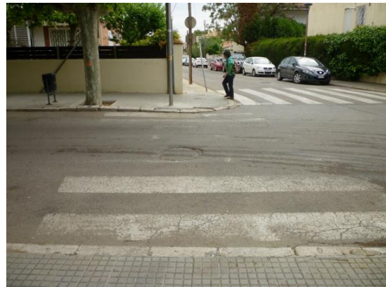
Imatge 64. Marques viàries del pas de vianants gairebé esborrades.
